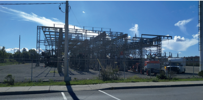
Le poste de transformation électrique. Source : AECOM
